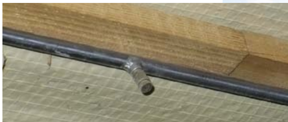
Linie zraszaczy powinny być zamontowane blisko wchodzącego do hali gorącego powietrza, a rozpylanie mgły musi się odbywać w kierunku ruchu powietrza
